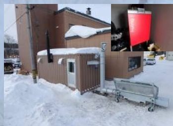
コンテナユニット型チップボイラー
