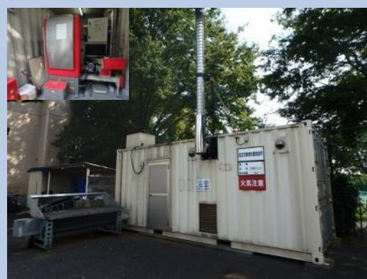
設置施設：東京都立大井町中央海浜公園 ボイラー：ハーガスナーWTH (100KW)
