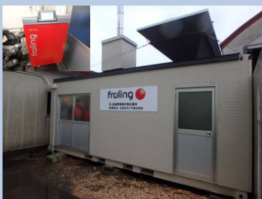
設置施設：様似町 ひだか南森林組合事務所 ボイラー：フローリングT4 (30KW)
