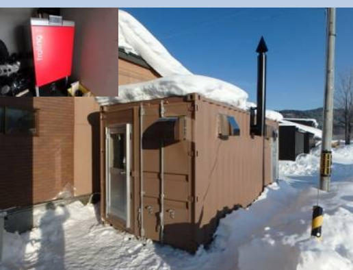
設置施設：上川町 小椋組事務所 ボイラー：フローリングT4 (50KW)
